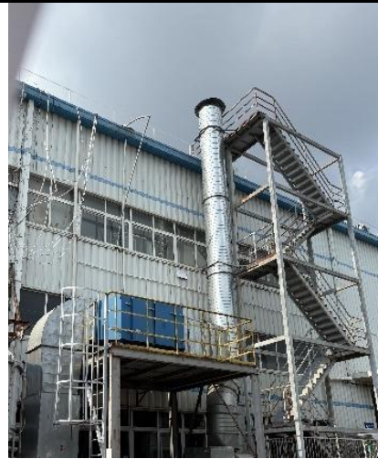
9#废气排气筒 (DA009)
