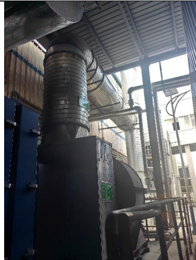
5#废气排气筒 (DA005)
