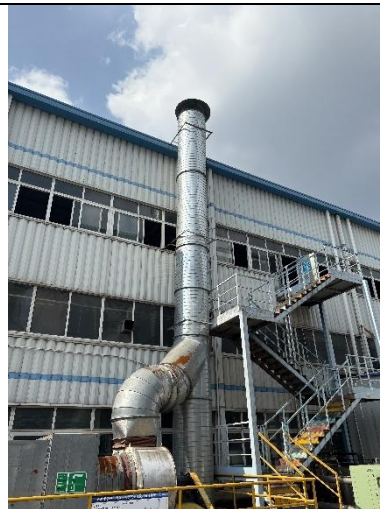
7#废气排气筒 (DA007)
