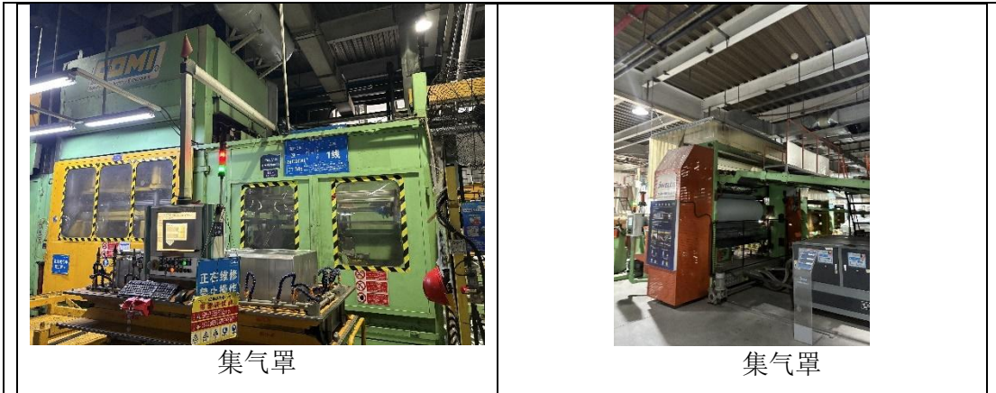
图 3-3 废气处理设施
