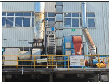
滤筒除尘器 (TA017) + 17#废气排气筒 (DA017)
