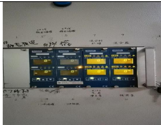
环戊烷泄漏报警器
