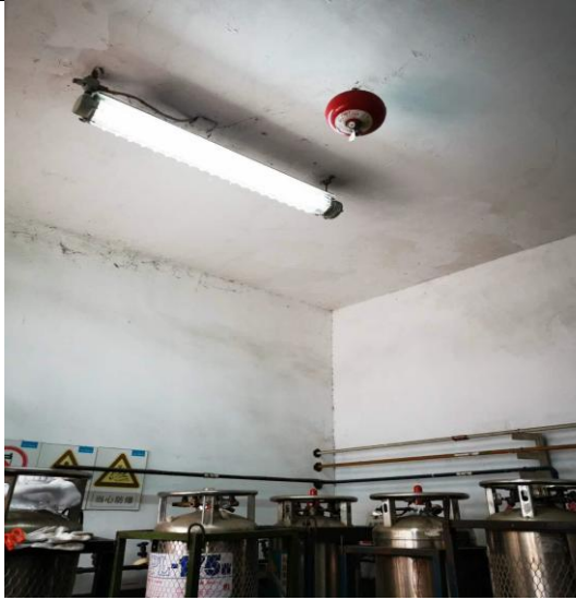
应急喷淋装置
