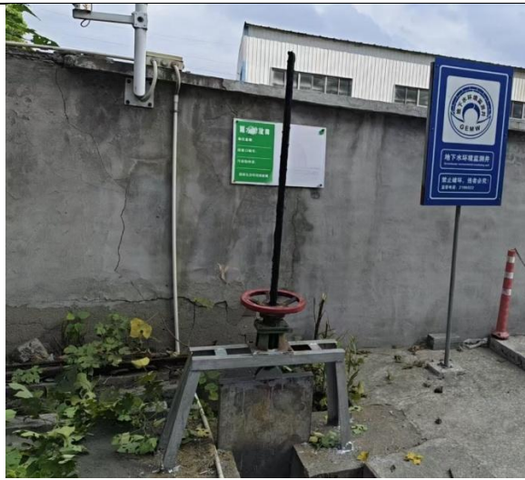
雨水排口切换闸阀
