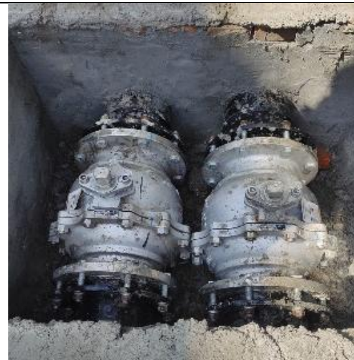
事故池切换闸阀
