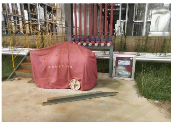
罐区外泡沫灭火装置
