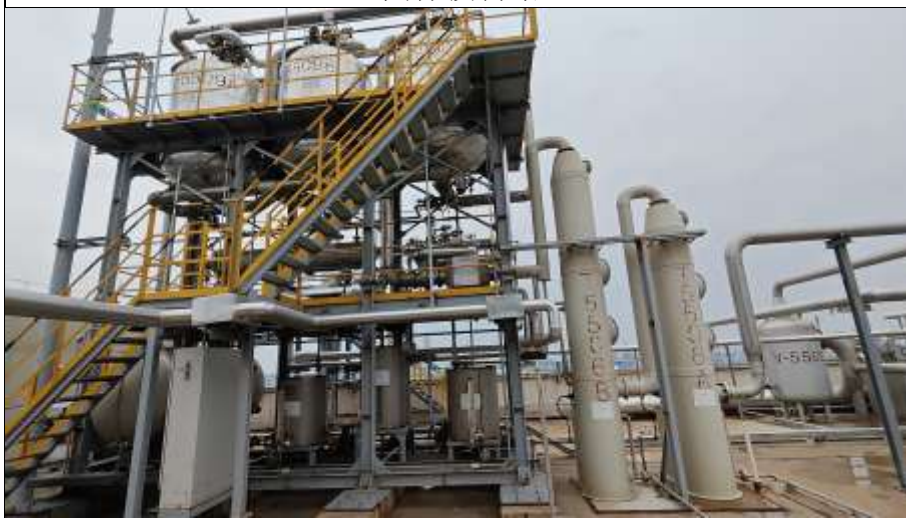
两级碱喷淋+树脂脱吸附（TA003）
