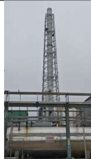
焚烧区排气总管
