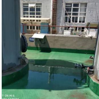
罐区可燃气体探测器
