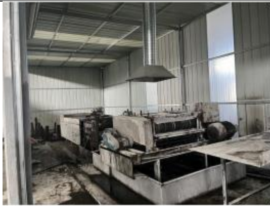
铁桶清洗线废气收集
