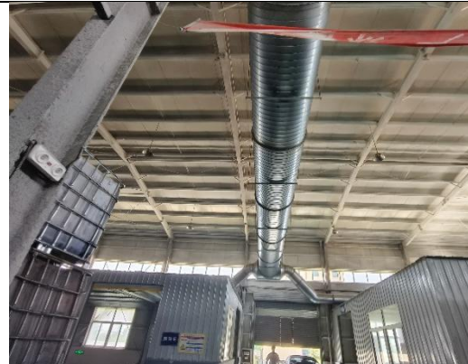
废气收集管线
