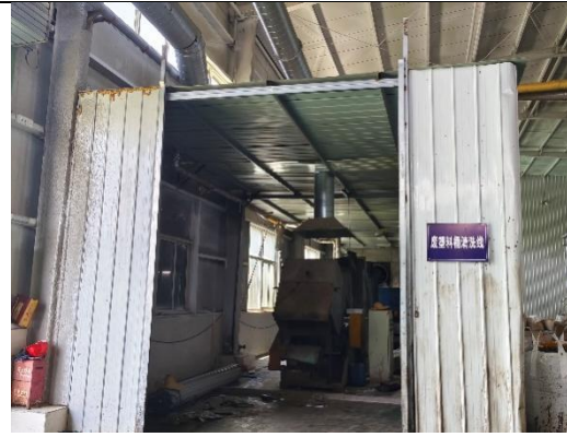
塑料桶清洗线废气收集
