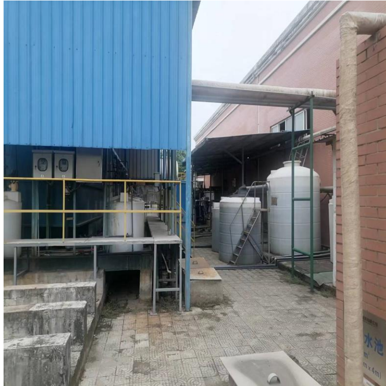
图 3-11 含铬废水处理设施
