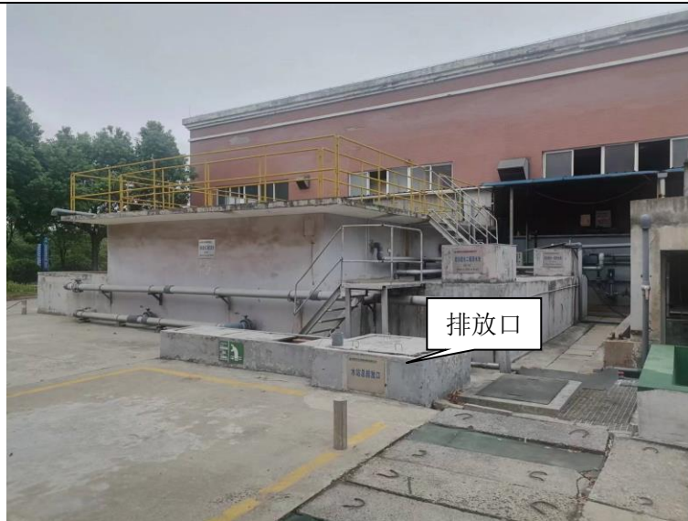
图 3-12 厂区综合污水处理站
