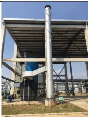
DA005 排气筒 (15m)
