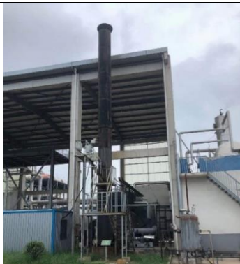
DA006 排气筒 (15m)
