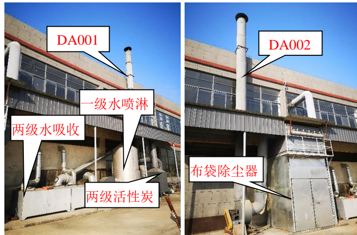
图 3-3 废气处理设施及排气筒
