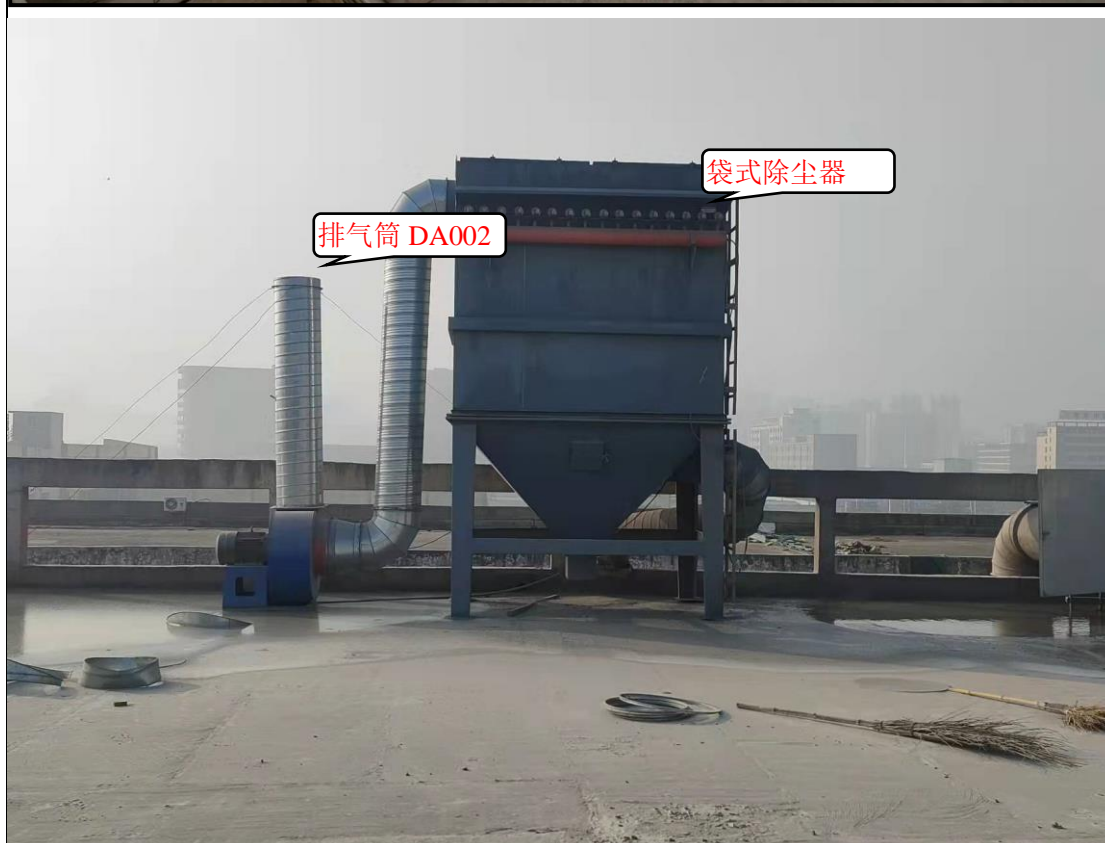
图 3-3 打磨车间废气处理设施
