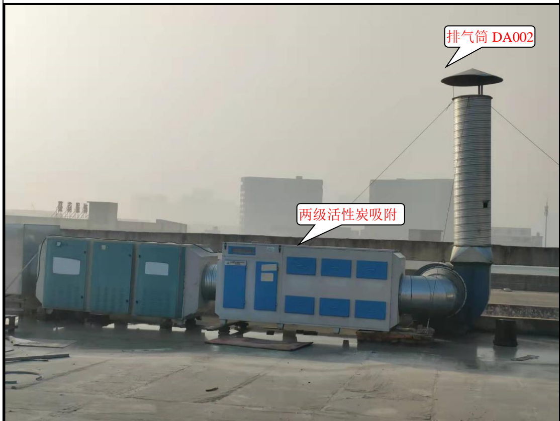
图 3-4 晾干车间、喷漆车间废气处理设施
