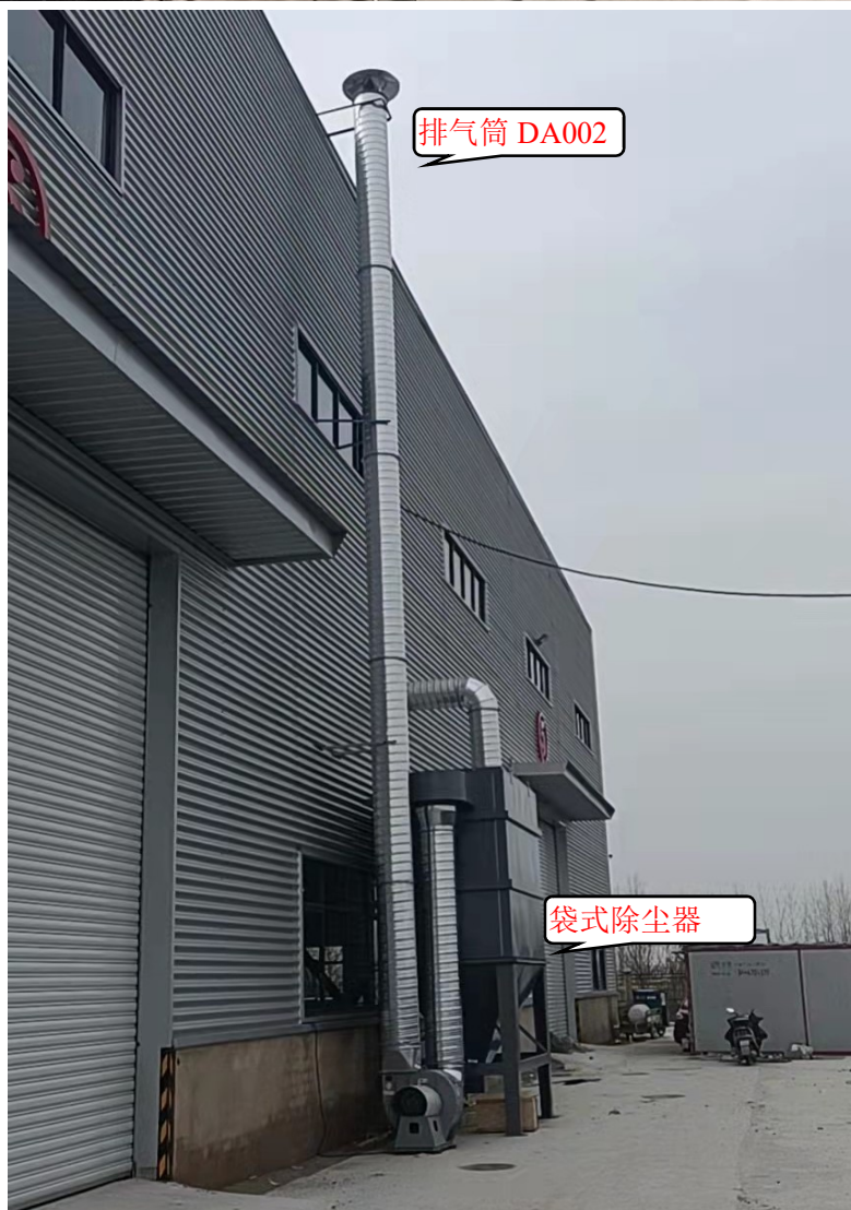
图 3-1 废钢打包除尘设施
