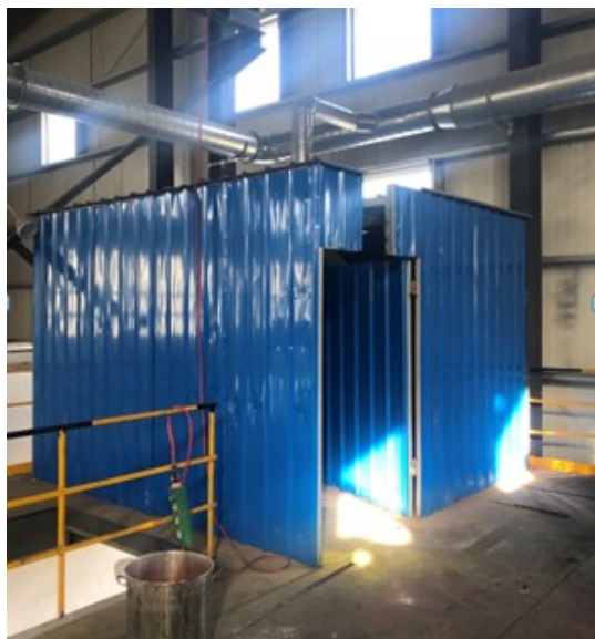
水性涂料车间拆包间
