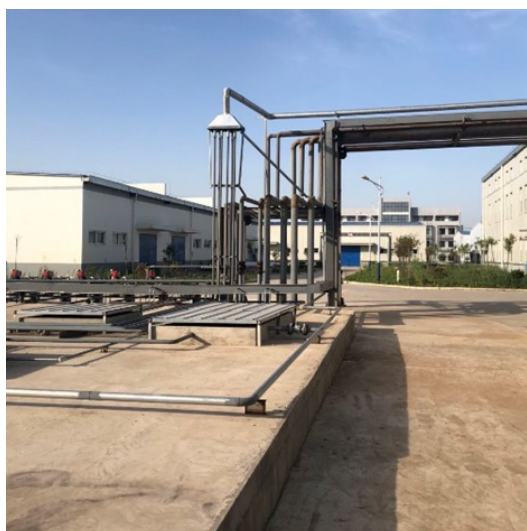
罐区呼吸气集气管道
