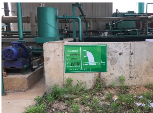
污水处理站监控池
