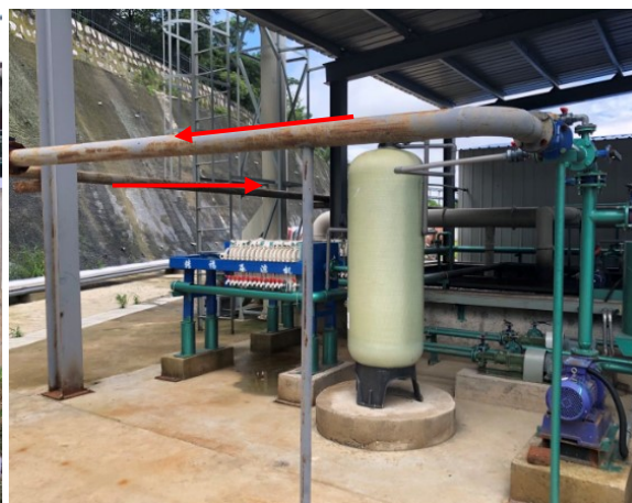
污水提升泵及外排管道
