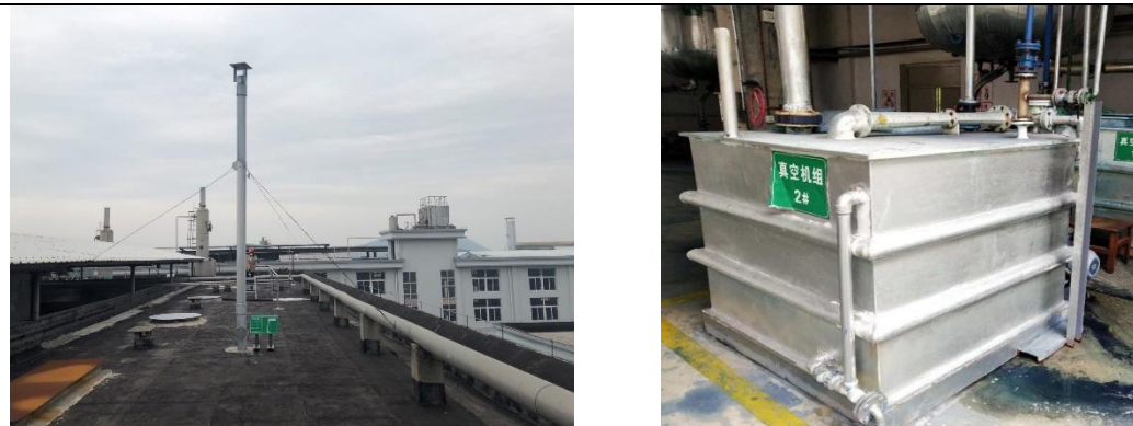
DA203 排气筒及废气治理设施
