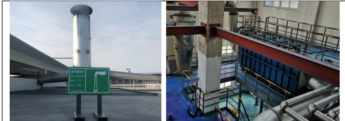
DA304 排气筒及废气处理设施
