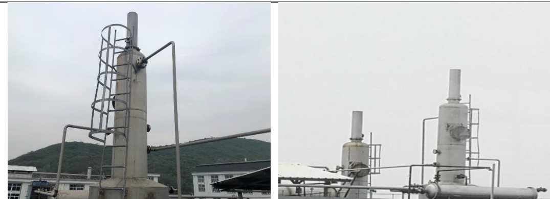
DA208 排气筒及废气治理设施
