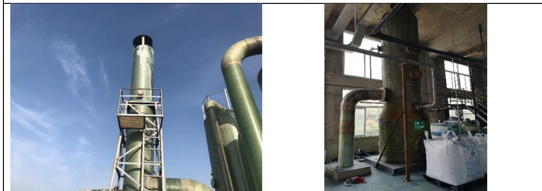
DA302 排气筒及废气处理设施
