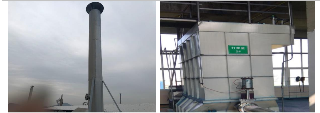
DA202 高排气筒及废气治理设施
