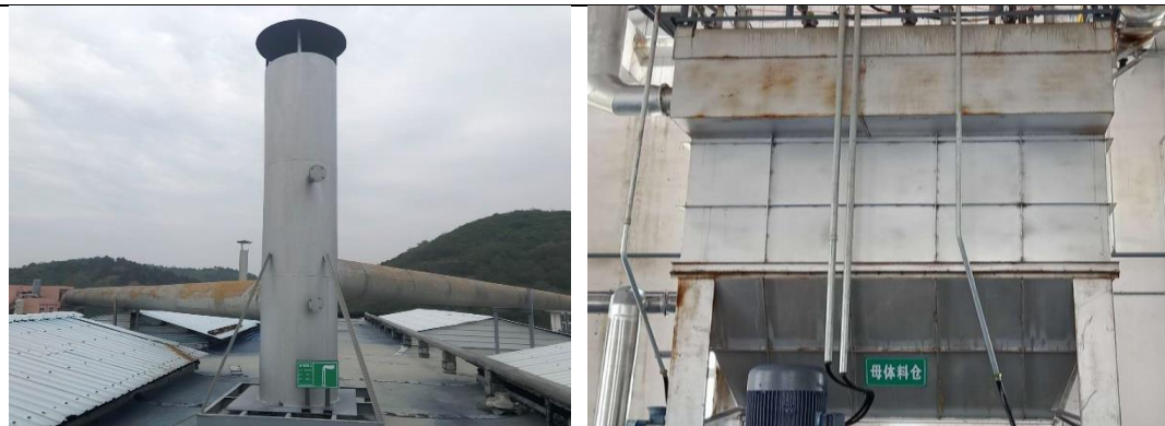
DA206 排气筒及废气治理设施
