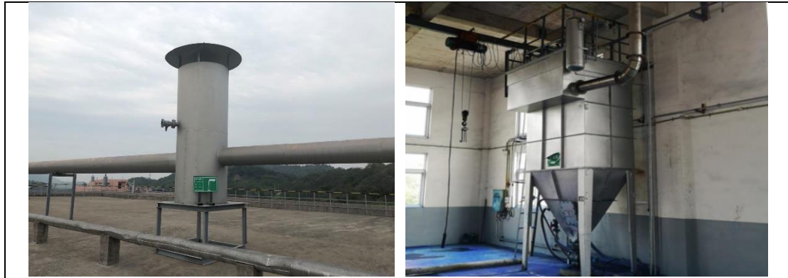
DA209 排气筒及废气治理设施
