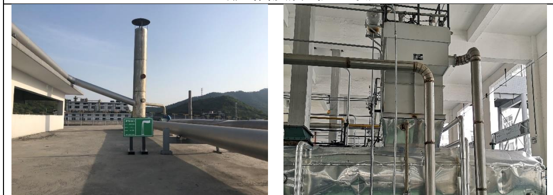
DA303 排气筒及废气处理设施
