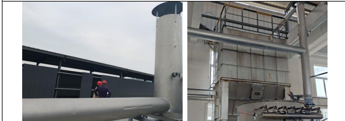
DA305 排气筒及废气处理设施
