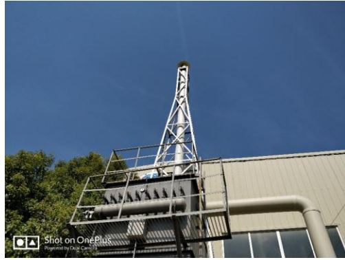
1#排气筒+检测平台
