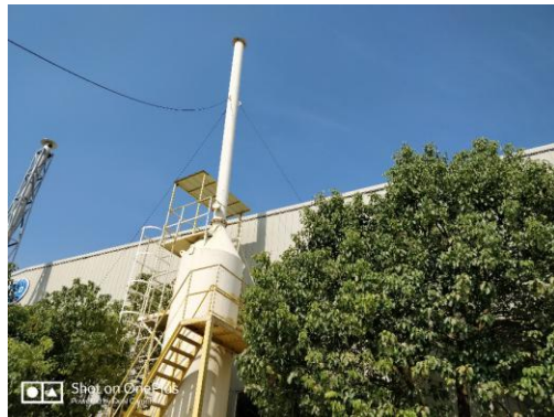
2#排气筒+检测平台
