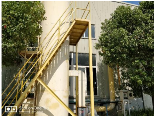
水喷淋吸收塔
