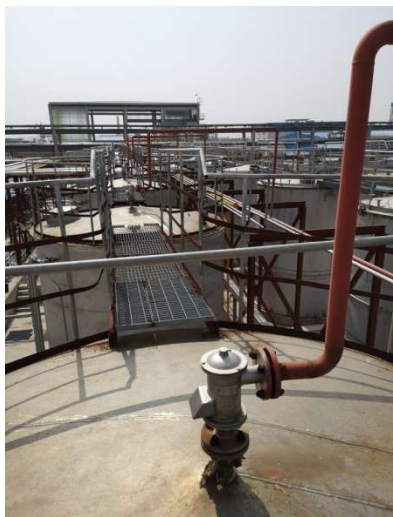
NMP 中间罐废气收集管
