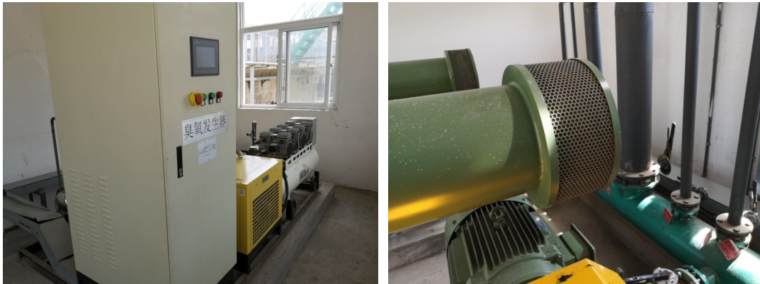
臭氧发生器设置机房
