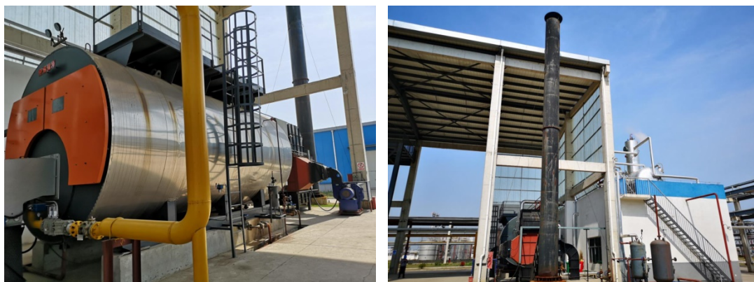
天然气蒸汽锅炉及15m高排气筒
