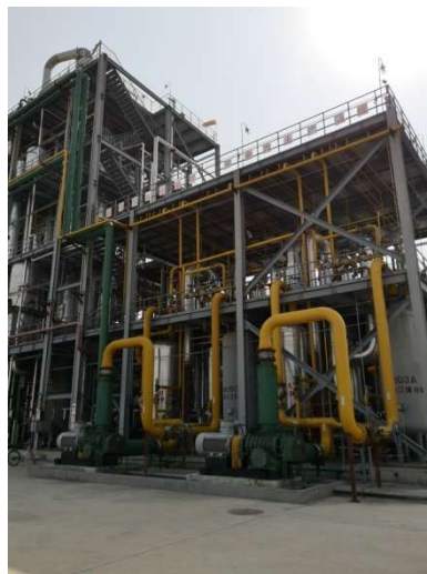
真空尾气收集管
