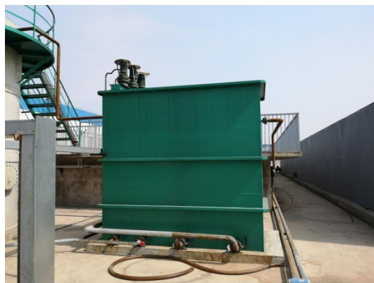
絮凝沉淀装置
