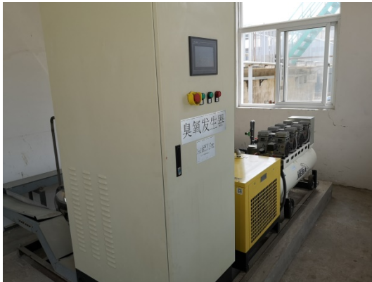
臭氧发生器设置机房
