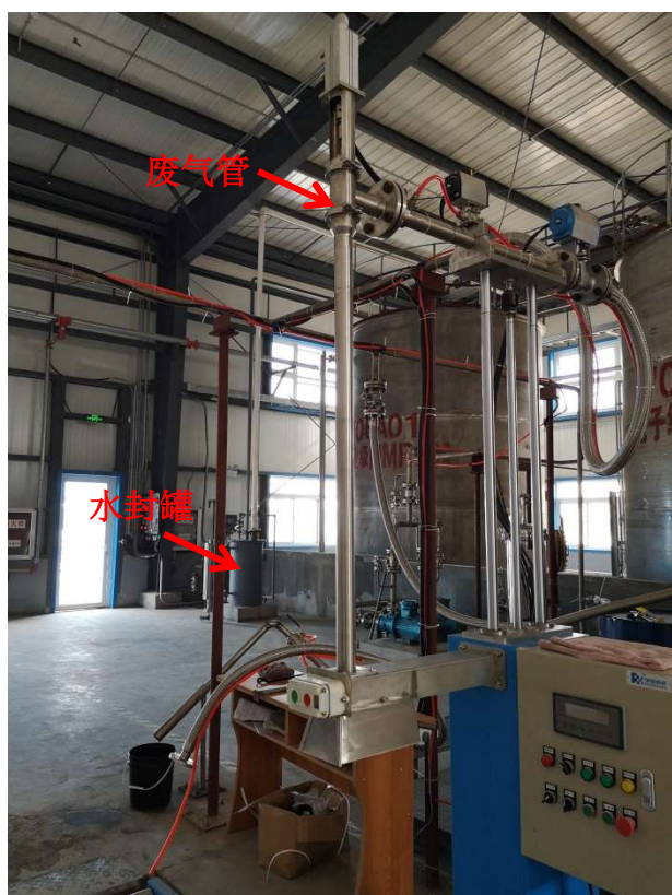
灌装废气收集管及水封
