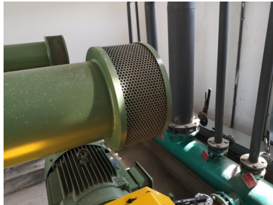
罗茨风机设置机房内且加装消声器
