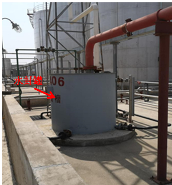
罐区呼吸气水封罐
